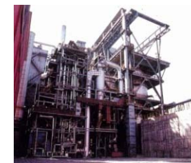
コークス乾式消火設備(CDQ)
