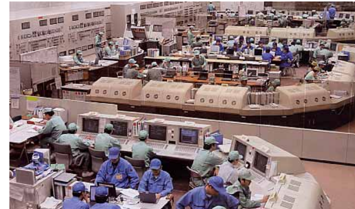
日本原燃 再処理工場 中央制御室
